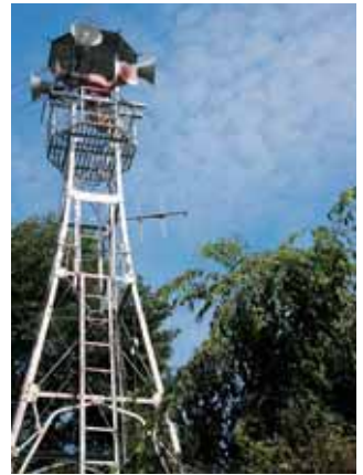
消防サイレン
