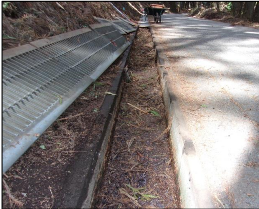
図1:側溝清掃前①
