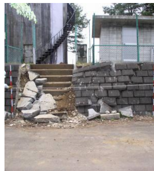
東日本大震災により被災した配水池
