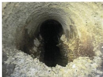
腐食が進んだ下水管
