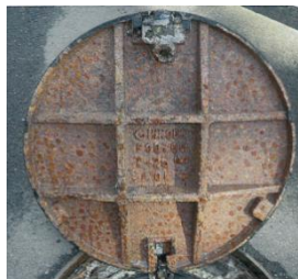
腐食が進んだマンホール蓋
