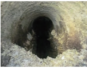
腐食が進んだ下水道管
