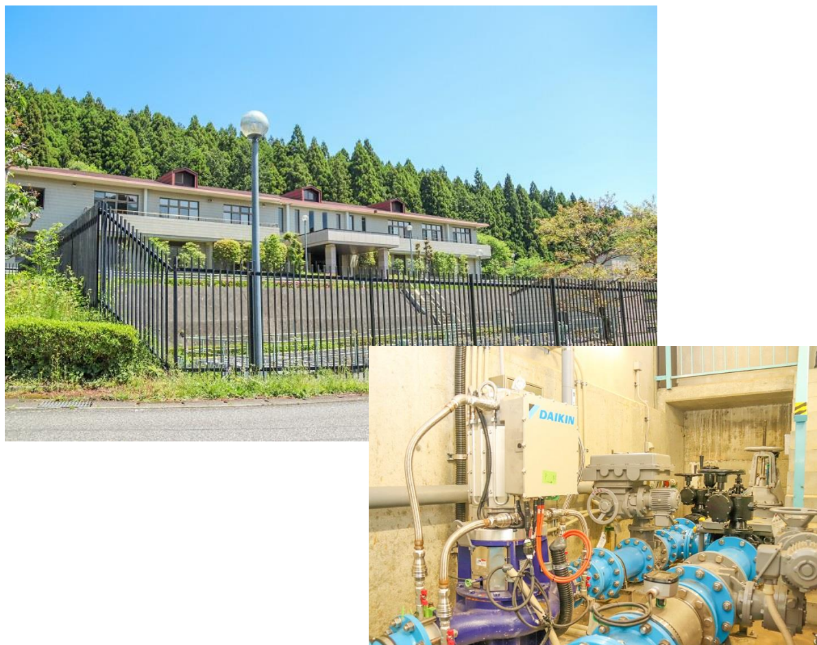
図4-2 寺山浄水場と発電設備
