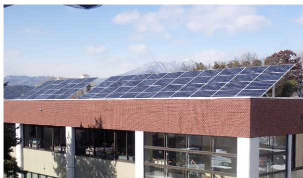
図6-3 市庁舎の太陽光発電設備
