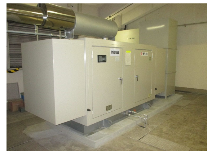
【マイクロ水力発電設備】
