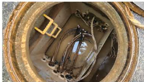
切断され盗難被害にあったケーブル（令和6年11月6日撮影）
