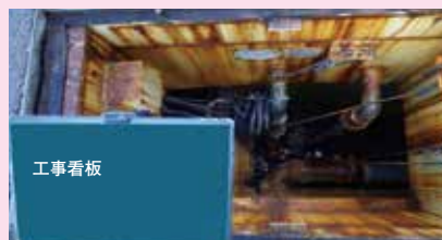
(工事前) 既設機器設置状況
