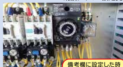
既設タイマー設定変更後
