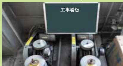
(工事前)既設機器設置状況
