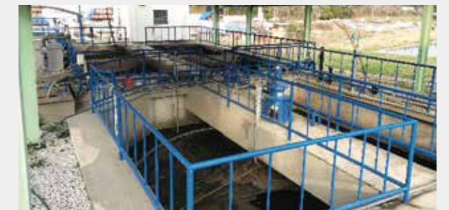
移管されるハッピーハイランド矢板の水処理施設
