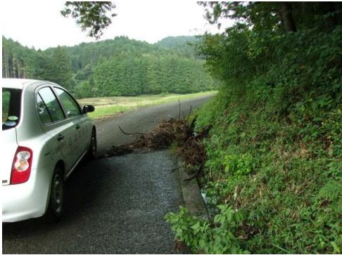
図1: 側溝のゴミ詰まり
