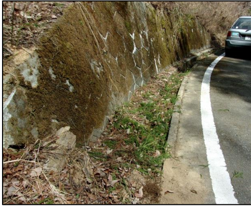
図1:側溝清掃前①
