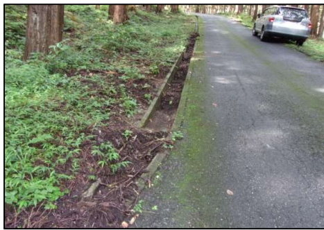
図1: 側溝清掃前①
