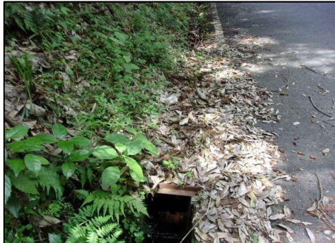
図1: 側溝清掃前①
