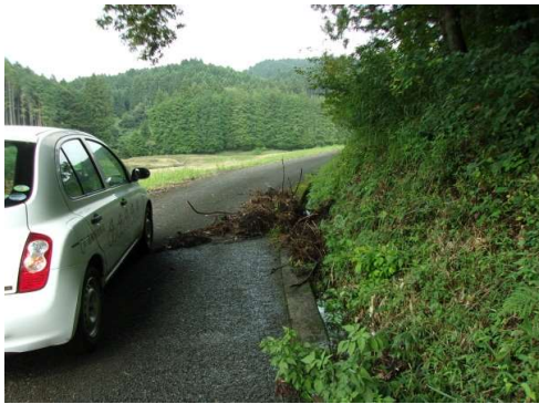
図1: 側溝のゴミ詰まり
